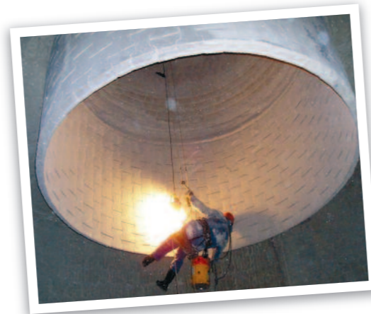
Wartung eines CVF, Tschechien. Ein Wartungsarbeiter inspiziert hier auf ungewöhnliche Weise. Normalerweise erfolgt die Inspektion visuell vom Schacht aus oder durch das Errichten eines Gerüsts
